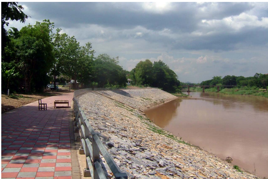
รูปที่ 14 เขื่อนป้องกันตลิ่งริมแม่น้ำยม ม.1 บ้านน้ำโค้ง ต.ป่าแมต อ.เมือง จ.แพร่
