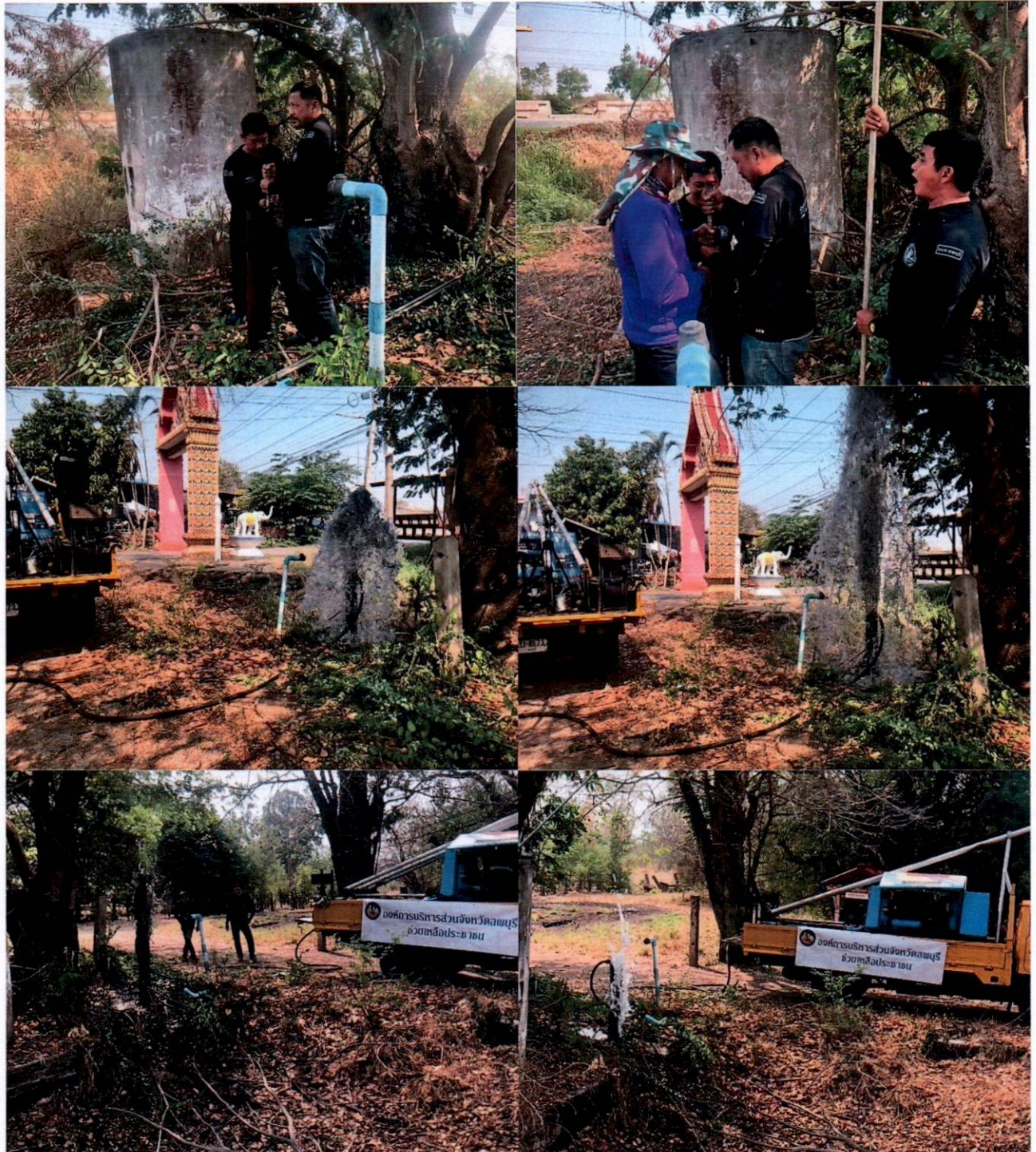
ระบบประปากลุ่มเนินเขาแหลม หมู่บ้านวังเพลิง หมู่ที่ ๑
